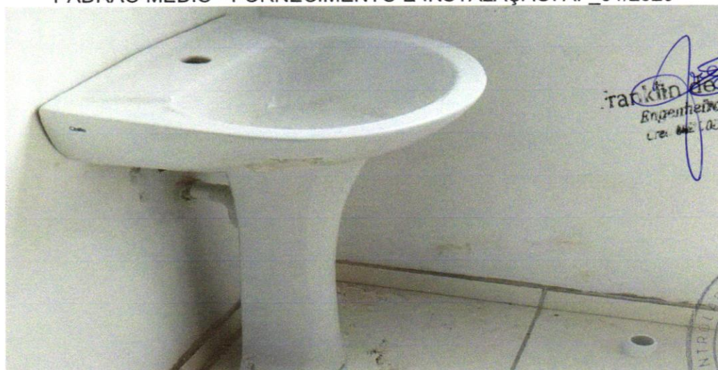
FOTO 04 - LAVATÓRIO LOUÇA BRANCA COM COLUNA, 45 X 55CM OU EQUIVALENTE, PADRÃO MÉDIO - FORNECIMENTO E INSTALAÇÃO. AF_01/2020
